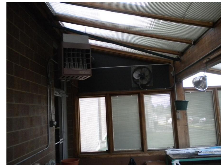
Figure 9. Greenhouse U.H. & Vent Fan
